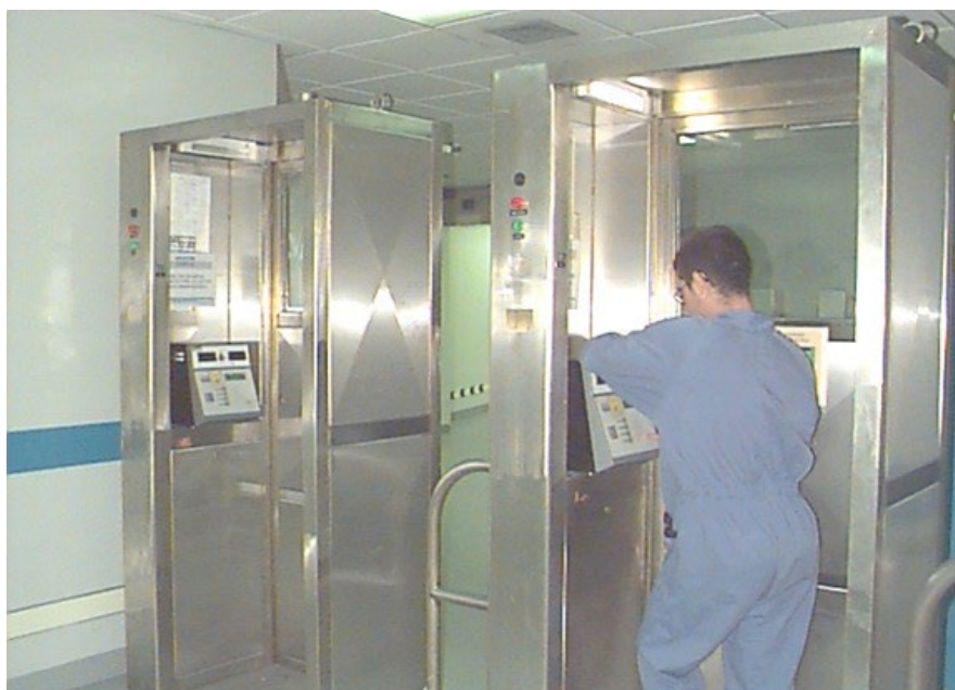
Control acceso a zona controlada
