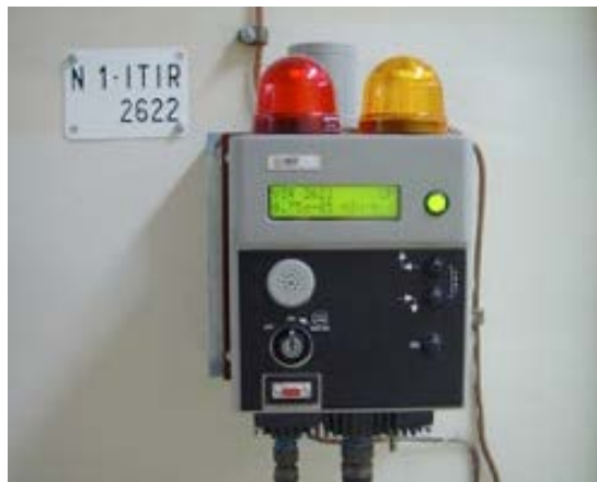
Sistema de vigilancia de la radiación
