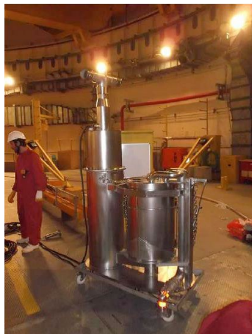
Equipos descontaminación química
