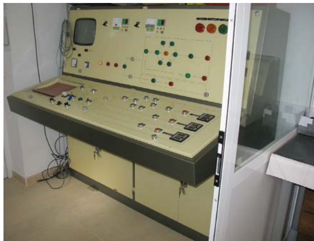
Panel de control de la sala de irradiación
