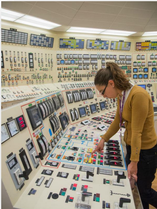
Figura 2. Sala de control
